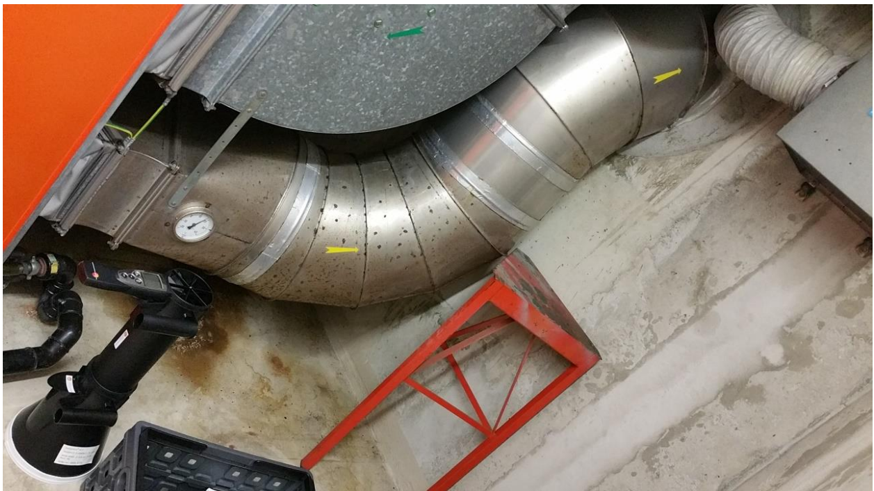
Abbildung 19: Korrosiver Fortluftkanal, ungedämmt wie der darüberliegende Frischluftkanal
