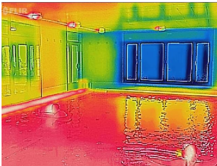
Abbildung 22: Thermobild in der Schwimmhalle: Der Abschirmungsvorhang des Zuluft-Luftschleiers reißt bereits unter der Fensterfassade aufgrund zu geringer Luftgeschwindigkeiten ab
