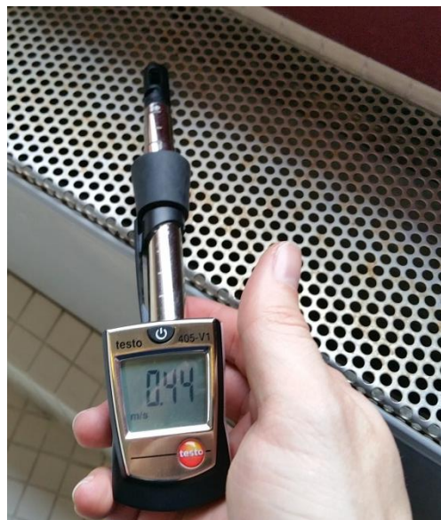
Abbildung 21: : Hydraulisch nicht optimierte Lüftungsschlitzschiene an der Fensterfassade begünstigt ein Beschlagen der Scheiben: Ist: 0,44m/s Luftgeschwindigkeit, Soll: 1,7-5m/s
