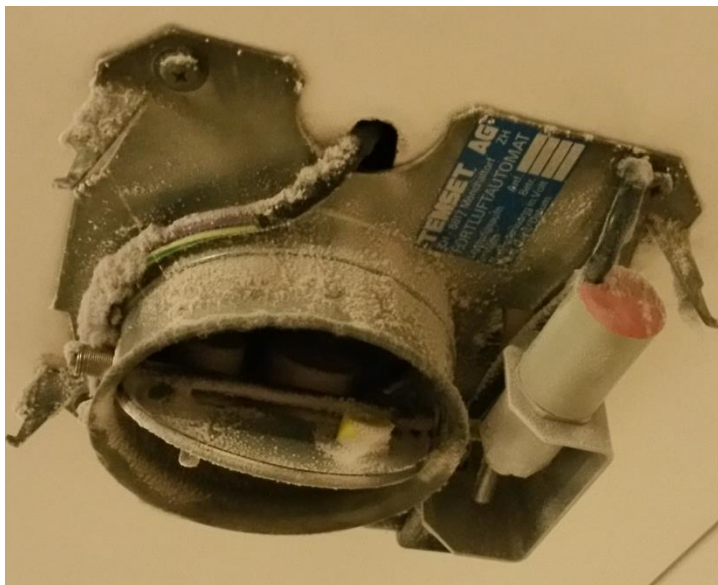
Abbildung 20: verdeckte variable Luftvolumenstrom-Abluftklappe im WC mit hohen Luftgeräuschen und damit zu hohen Strömungsgeschwindigkeiten
